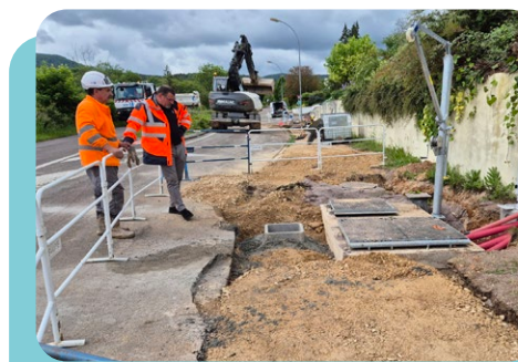
Poste de refoulement - Velars/O.
