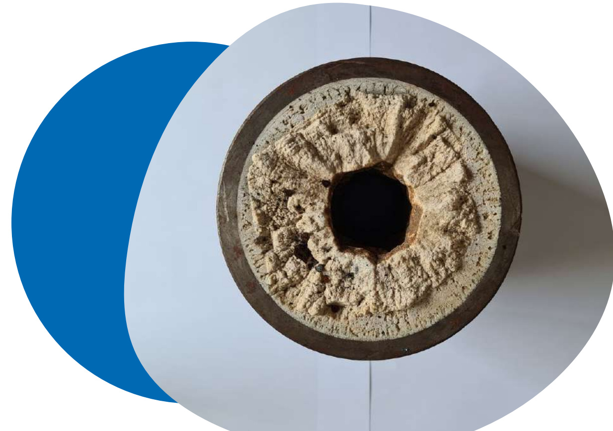
Canalisation remplie de tartre - Commune de Remilly-en-Montagne
