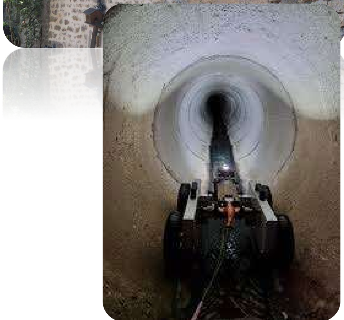
Passage camera (Connaissance de l'état des réseaux)
